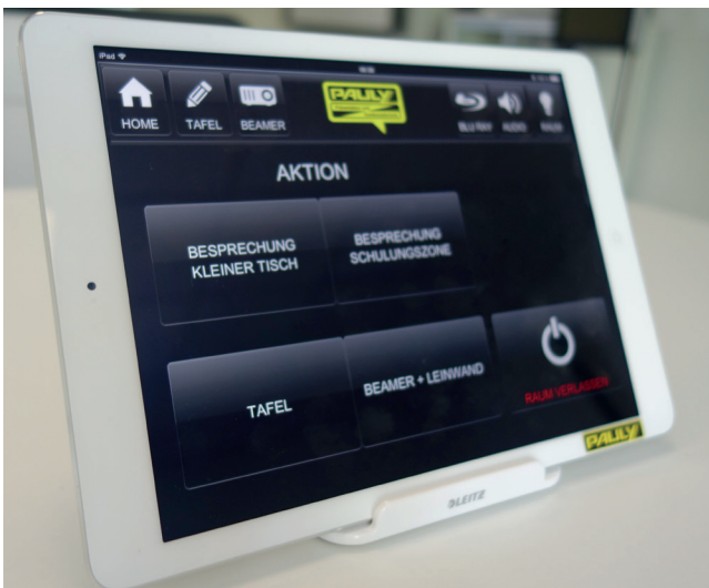
Die Bedienung der Medien- und Raumtechnik erfolgt über ein Crestron Touchpanel und über ein iPad mit spezieller Software
